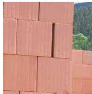
Nevyplněná spára je téměř vždy příčinou vzniku trhliny ve fasádě
