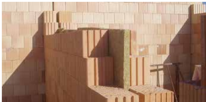
Mezera u dvojitě zděné stěny se postupně vyplňuje zvukově pohltivým materiálem, např. minerálními deskami určenými pro tlumení kročejového hluku
