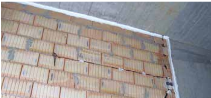
Vodorovnou spáru mezi stropní konstrukcí a akusticky dělicí stěnou vyplňte stlačitelnou zvukovou izolací
