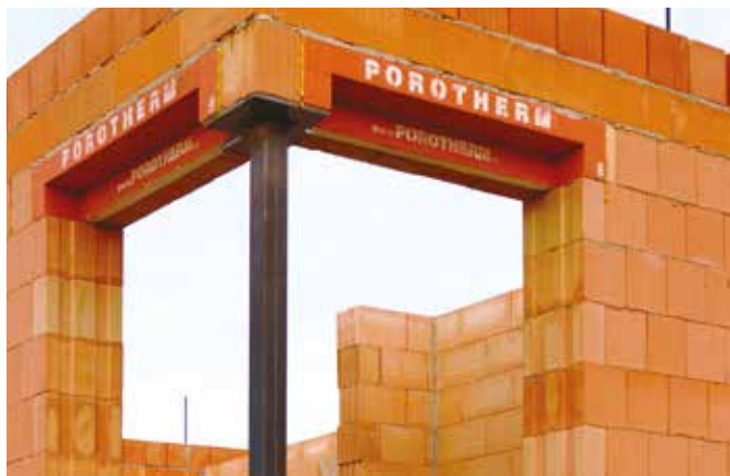
Pro jednoduchou realizaci stačí doplnit příklady ocelovým sloupkem a ocelovou hlavicí svařenou z válcovaných profilů
