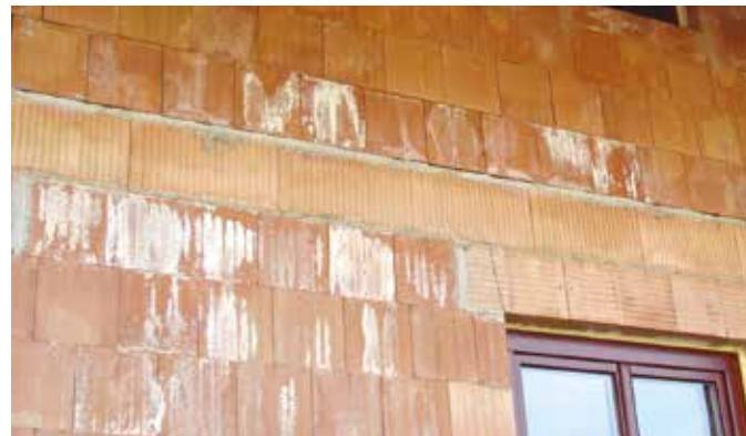
Výkvěty na zdivu vznikají pouze tam, kde je ve zdivu zvýšená až nadměrná vlhkost. Před aplikací omítek je nutné je z povrchu zdiva odstranit.
