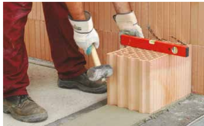
Příklad napojení vnitřní nosné stěny z cihel Porotherm 24 Profi na obvodovou stěnu z cihel Porotherm 30 Profi
