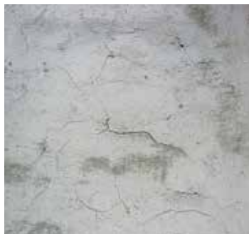
Nepravidelně popraskaná omítka vlivem extrémně suchého prostředí
